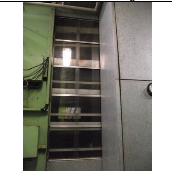
A Binder szárító berendezés ellenőrző ablakai, (5 szinten vezetett szalag)
