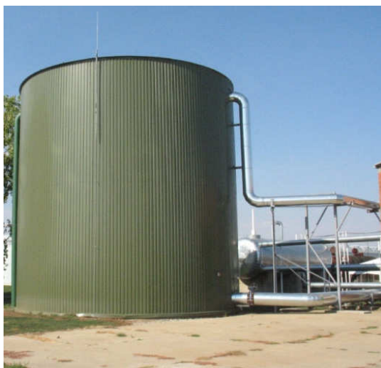
4.43. ábra 750 m 3 -es könnyűszerkezetes termámvíz kiegyenlítő tároló (Szegvár)
