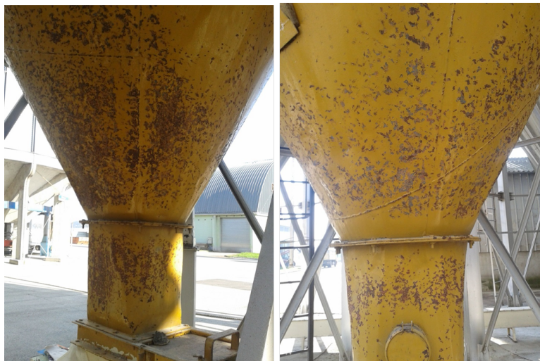
2.22. ábra 30°-os félkúpszögű, 100 m 3 térfogatú, siló, kalapácsnyomokkal a Gyermelyi Zrt. takarmánykeverő üzemében
