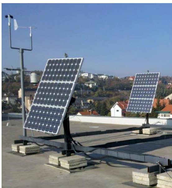
52. ábra. A fotovillamos és az adatgyűjtő rendszer a PTE-PMMIK főépület tetején
