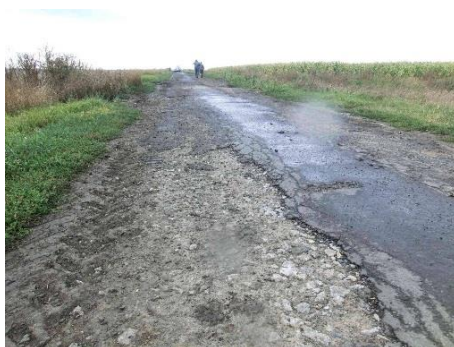
2.5. ábra: Töredezett borítású kátyús aszfaltozott útszakasz
