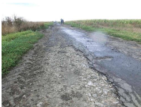
3.34. ábra: Töredezett borítású kátyús aszfaltozott útszakasz
